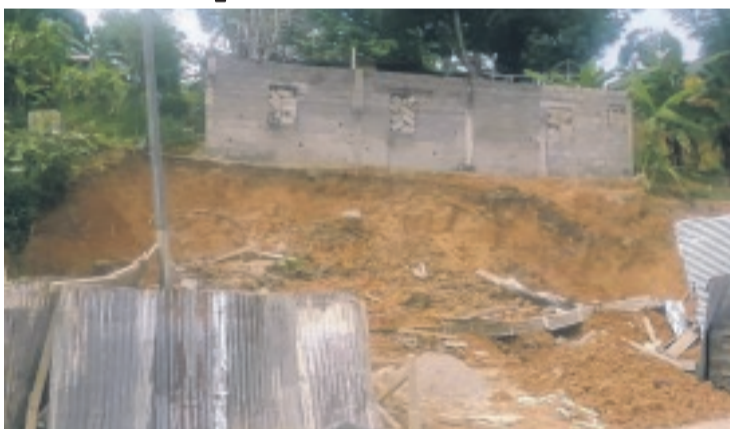
L'état des lieux après l'effondrement.
