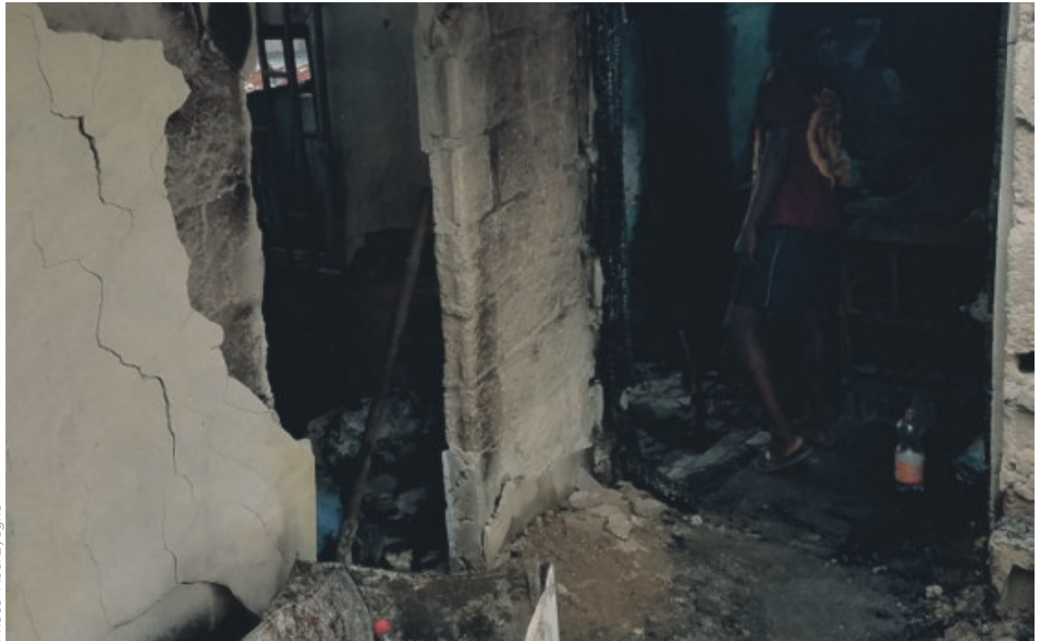
Une partie de l'habitation détruite par les flammes.
