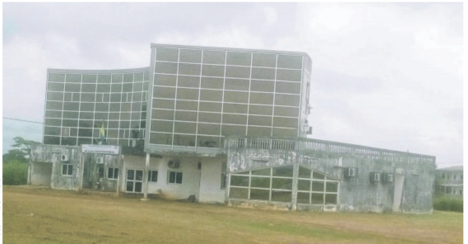
Le bâtiment abritant la mairie de Bikelé, par manque d'entretien, présente un visage hideux aux visiteurs.
