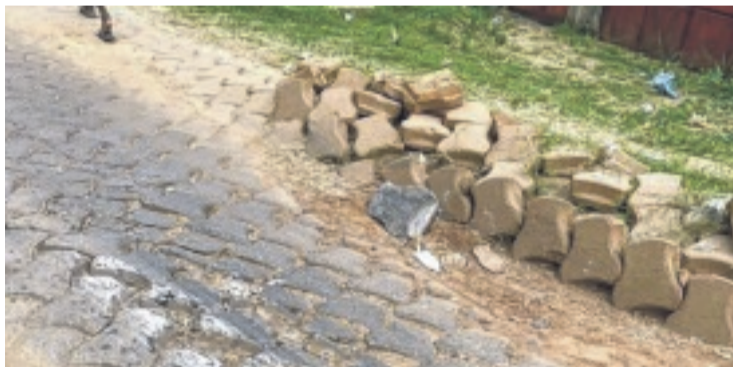
Pavés de Nzeng-Ayong en dégradation moins d'un an après leur pose.
