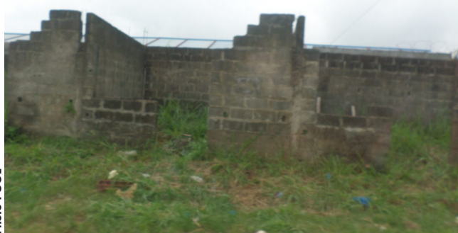
Une maison non terminée au quartier Bananier dans la commune d'Owendo, des lieux de prédilection pour les bandits.
