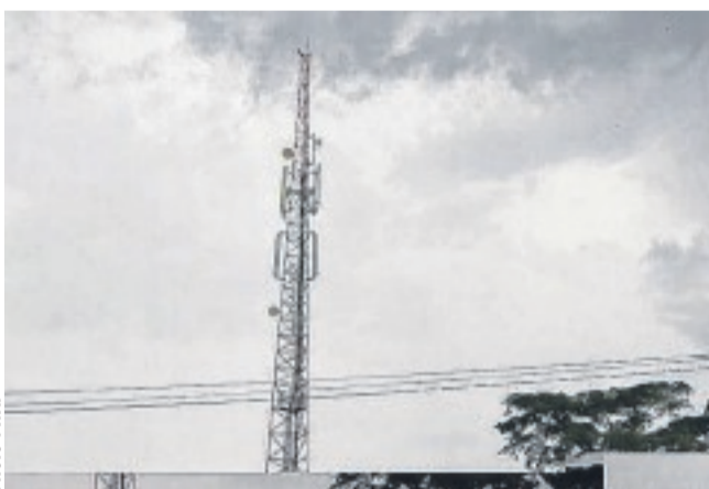
Le renouvellement des installations s'impose pour une meilleure couverture.
