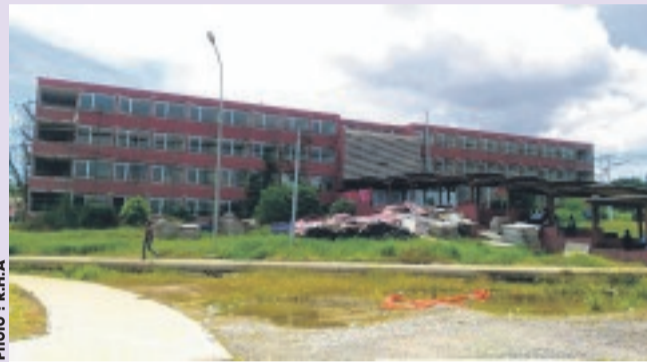
Les autres bâtiments du campus attendant d'être réhabilités.
