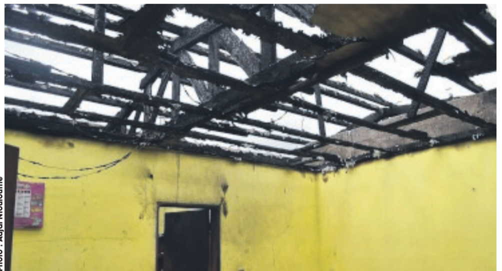
Les toitures n'ont pas résisté aux flammes.
