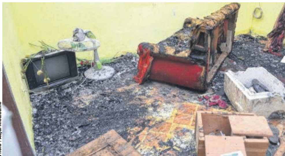
L'un des deux studios après le passage du feu.
